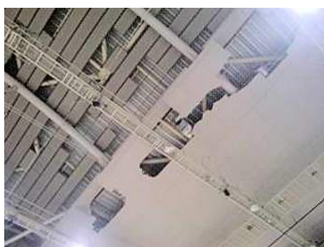
天井の一部が壊れ落ちたビッグパレット
